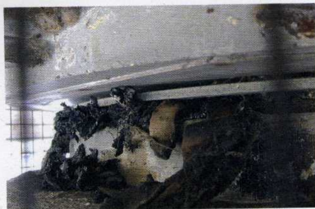
Schäden am Lager der Brückenpfeiler
