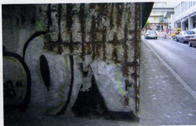
Rostende Armierung infolge Vernässung
