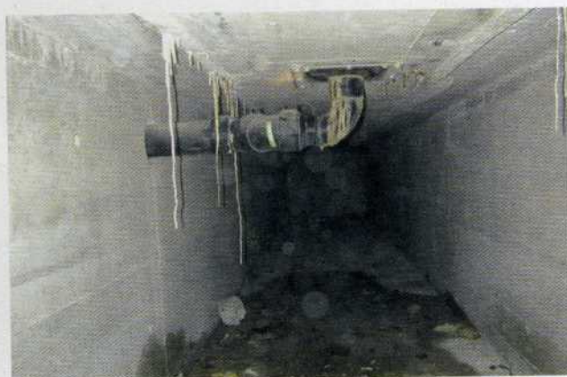
Undichte Fahrbahnplatte und Brückenentwässerung
